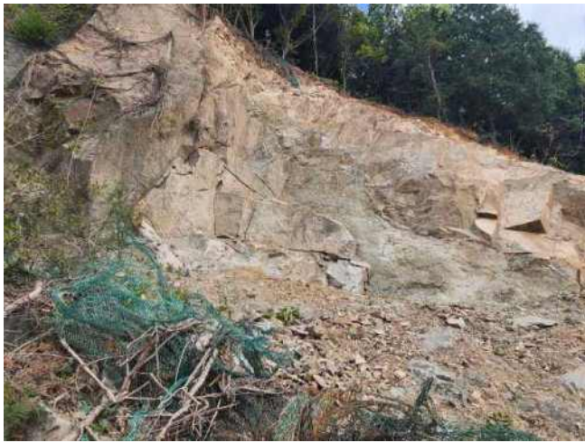
[사진 7] 암반사면 붕괴 현황
