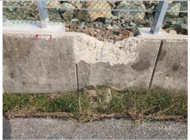
[사진 4] J형 수로 파손
